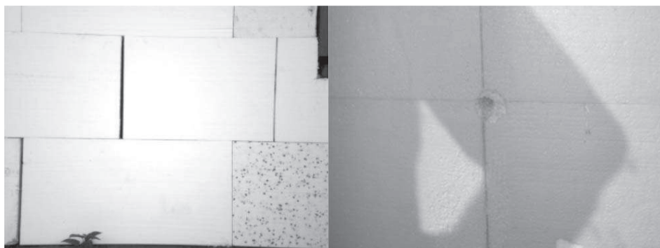
Ryc. 3. Błędy w układaniu płyt styropianowych (materiały szkoleniowe firmy Baunit)
