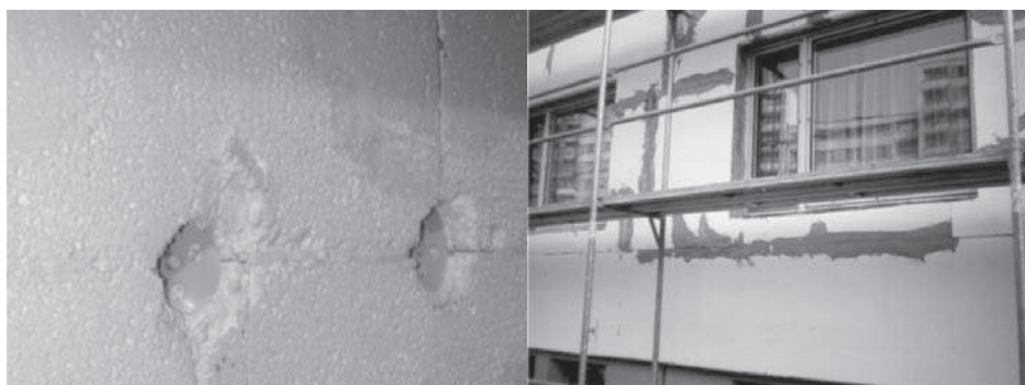
Rys. 4. Szpachlowanie połączeń płyt styropianowych, brak ocieplenia ościeży okiennych oraz uszkodzenie warstwy termoizolacyjnej przy zastosowaniu łączników (materiały szkoleniowe firmy Baunit)
