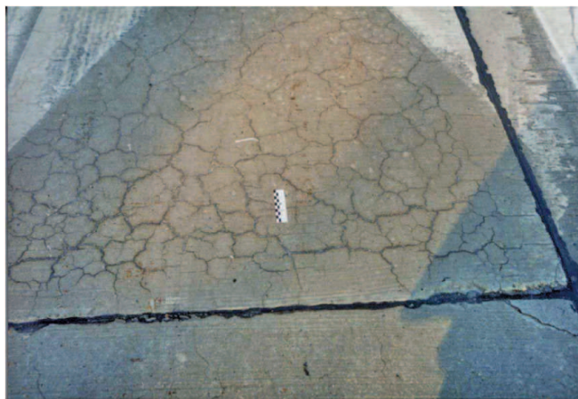
Ryc. 1. Plac parkingowy – pęknięcia wywołane reakcją ASR [1]
