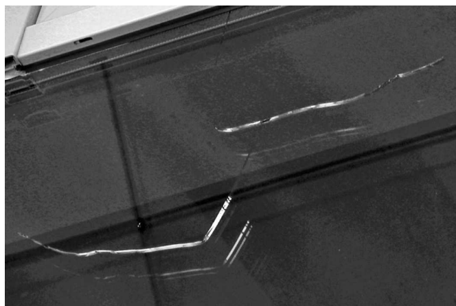
Ryc. 4. Pęknięcie w szybie zespolonej wynikłe ze zbytniego dopasowania szyby zespolonej do elementów konstrukcji
