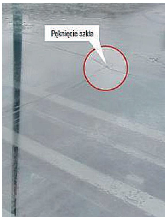
Ryc. 9. Pęknięcie w szybie zespolonej spowodowane naprężeniami termicznymi
