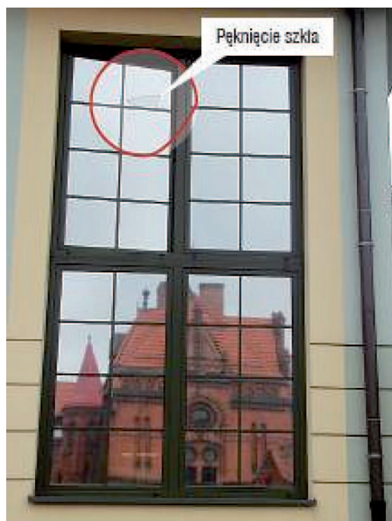
Ryc. 8. Pęknięcie spowodowane nierównomiernym nagrzaniem szyby zespolonej
