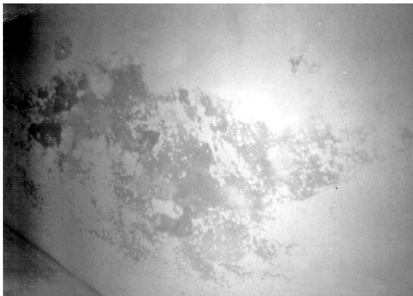
Ryc. 8. Widok rozległych plam na powierzchni tynku [9]
